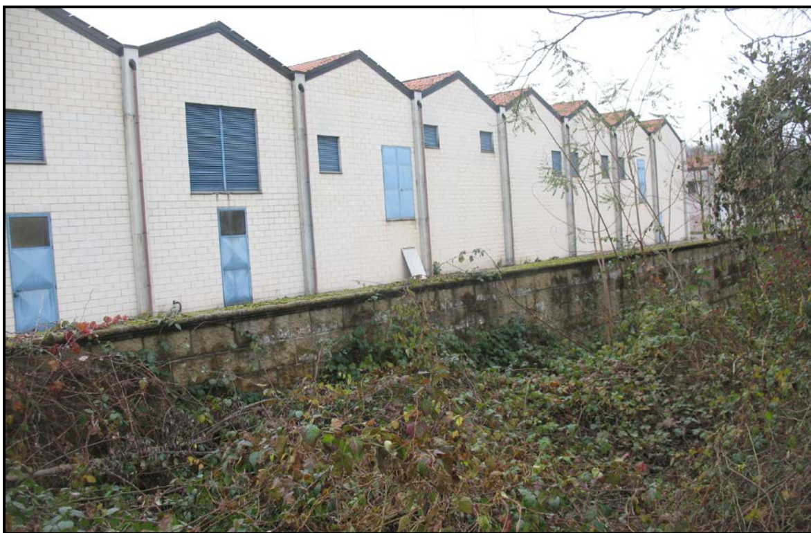
Figura 28: dettaglio dei capannoni dell'impianto di depurazione consortile di Gornate Olona, ripreso dalla sponda sinistra del fiume con evidenza del rilevato eretto a protezione dalle piene fluviali
