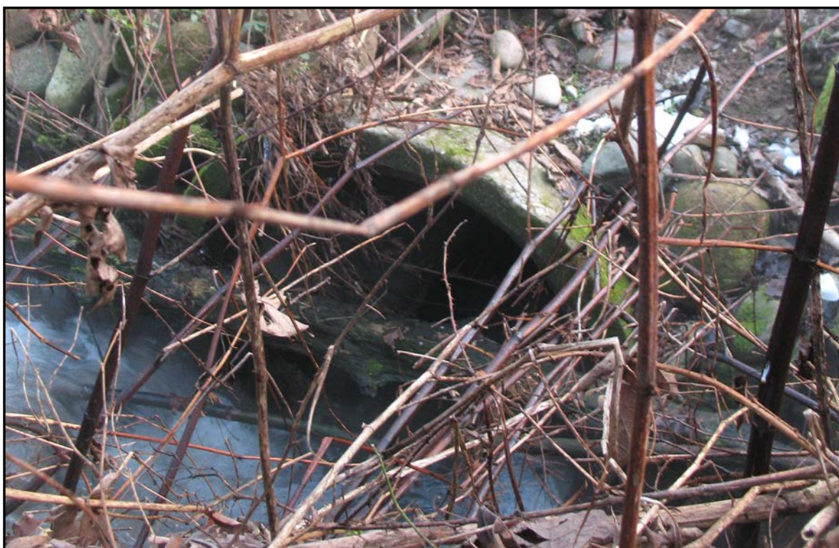
Figura 44: particolare ripreso presso la pista ciclopedonale di fondovalle, con evidenza (seminascosta dalla vegetazione) della calotta superiore del tubo f 110 cm posato in attraversamento del rilevato stradale
