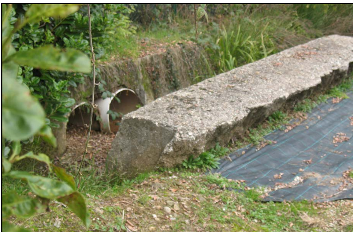
Figura 37: sezione di uscita della tombinatura già raffigurata nell'immagine precedente, in direzione di un canale ricavato in proprietà privata, con evidenza degli accumuli di materiale presso l'uscita dei condotti
