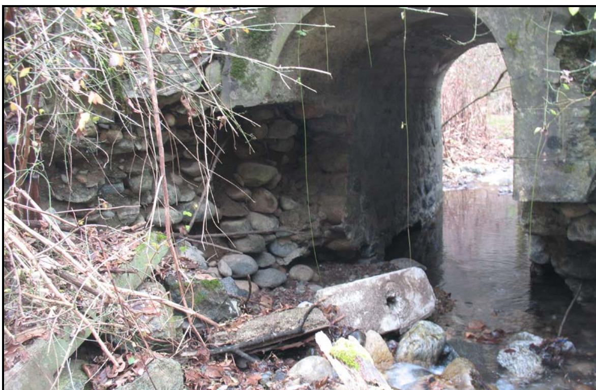
Figura 32: dettaglio delle lesioni murarie alla base del manufatto di attraversamento
