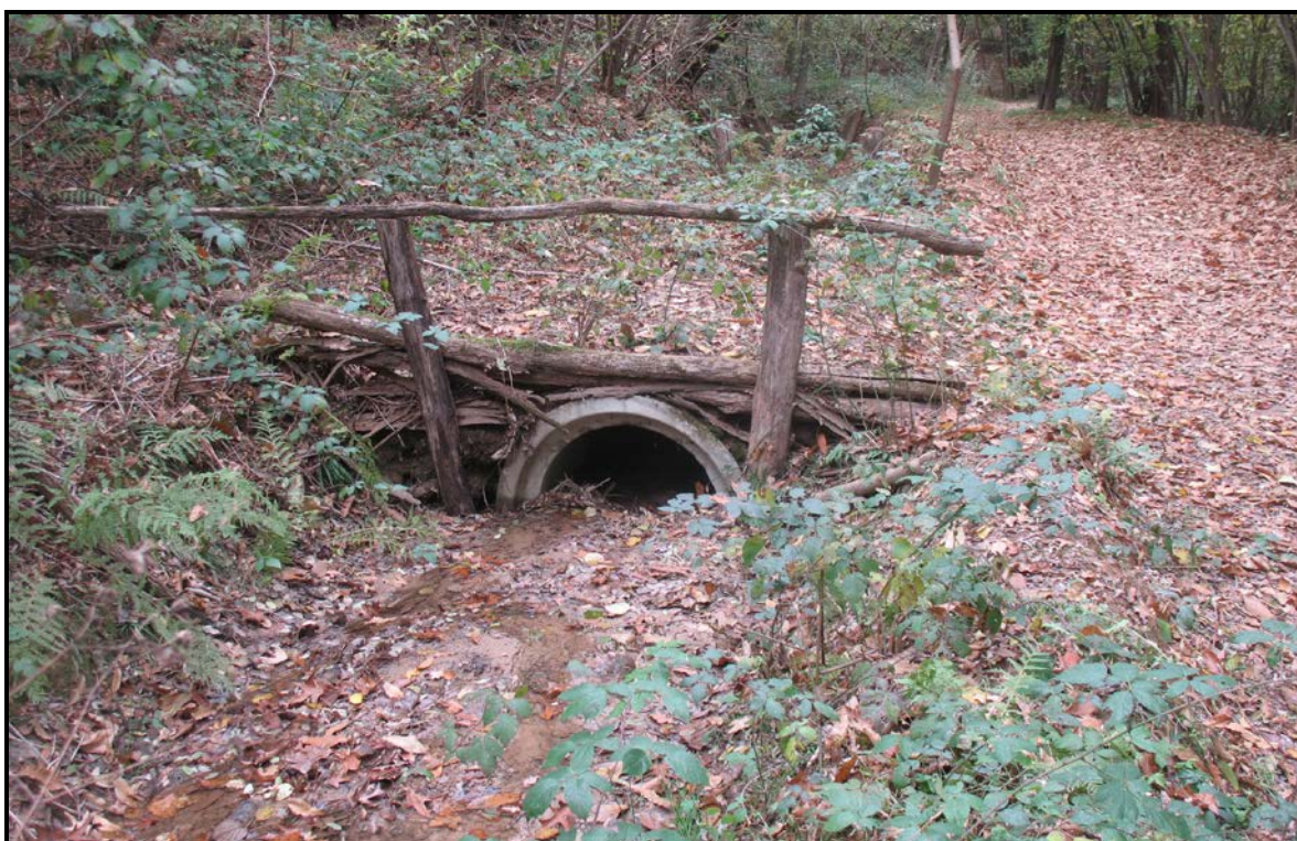
Figura 34: dettaglio in corrispondenza della sezione di imbocco di un secondo attraversamento, interessato da rilevante attività di deposito
