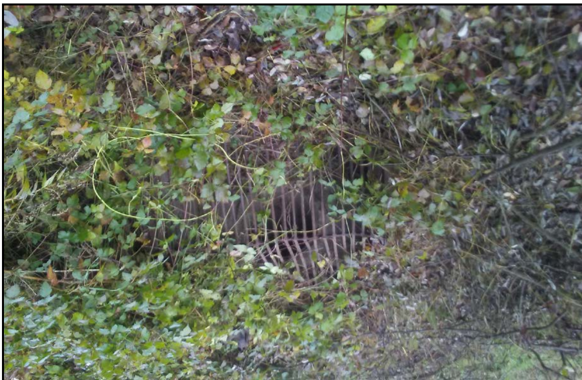
Figura 59: dettaglio del manufatto ove trovano recapito le acque scolanti dal bacino n. 14, con evidenza della griglia di protezione, dietro alla quale si intravede la sagoma di una tubazione di recapito (calcestruzzo f 40 cm).
