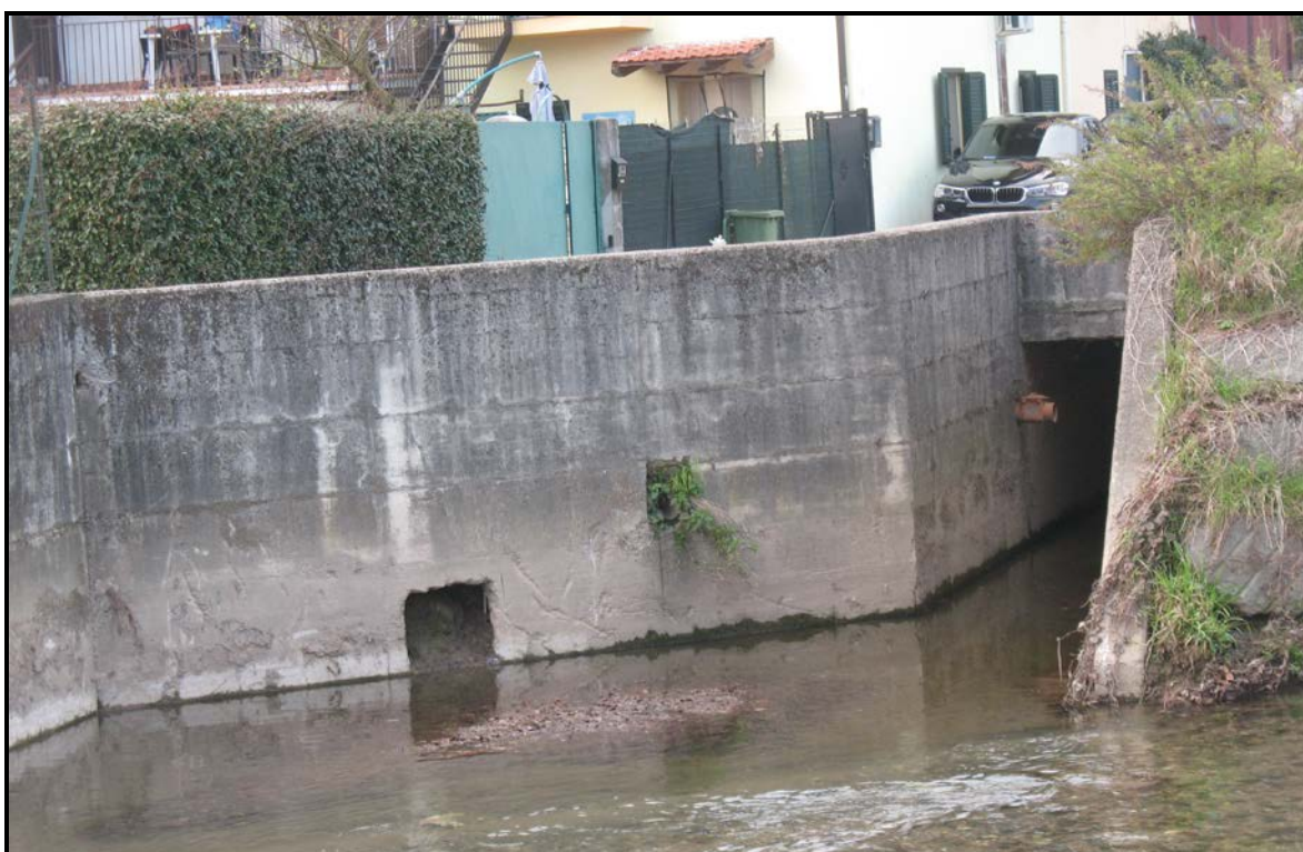
Figura 57: lo sbocco della tombinatura terminale, nel muro in sponda destra a valle del ponte di via Battisti, sul fiume Olona
