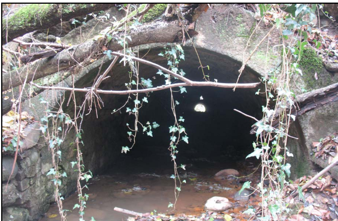
Figura 47: la sezione di imbocco del cunicolo di sottopasso della S.P. 42, costituito da un vano con copertura a volta, di raggio pari a circa 1,00 m)
