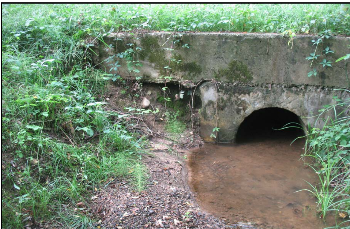
Figura 51: la sezione terminale della tombinatura sotto alla sede stradale di via primo Maggio, con evidenza dei segni dell'erosione provocati dalle correnti di divagazione sul piano stradale, che tendono qui a rientrare in alveo
