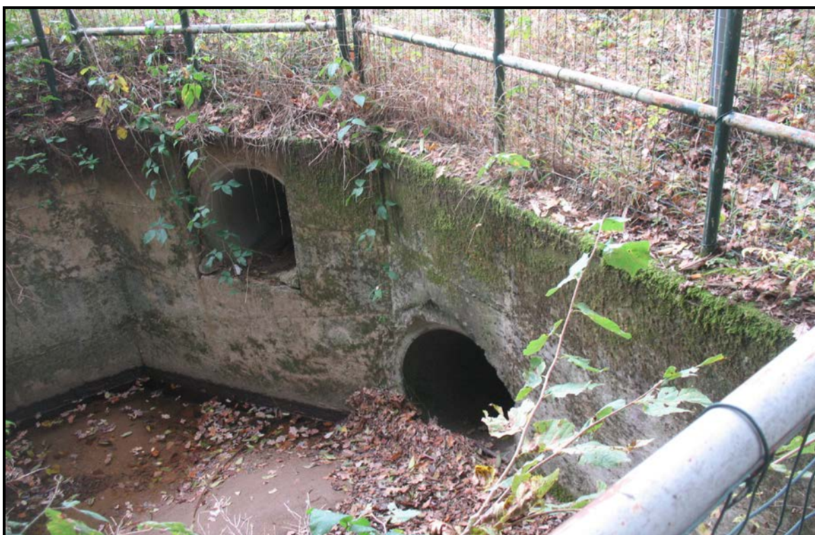
Figura 42: particolare del manufatto di ripartizione delle portate realizzato ai piedi del pendio, con evidenza del condotto \varnothing 80 cm, sul fondo (al centro della foto), destinato a deviare verso Sud la maggior parte delle portate affluenti, per il tramite di una condotta (non rilevata) dello sviluppo approssimativo di 320 m; a tale condotto si aggiunge (in posizione più elevata, leggermente spostato a sinistra) il condotto \varnothing 70 cm destinato invece a mantenere traccia dell'originario percorso dell'alveo
